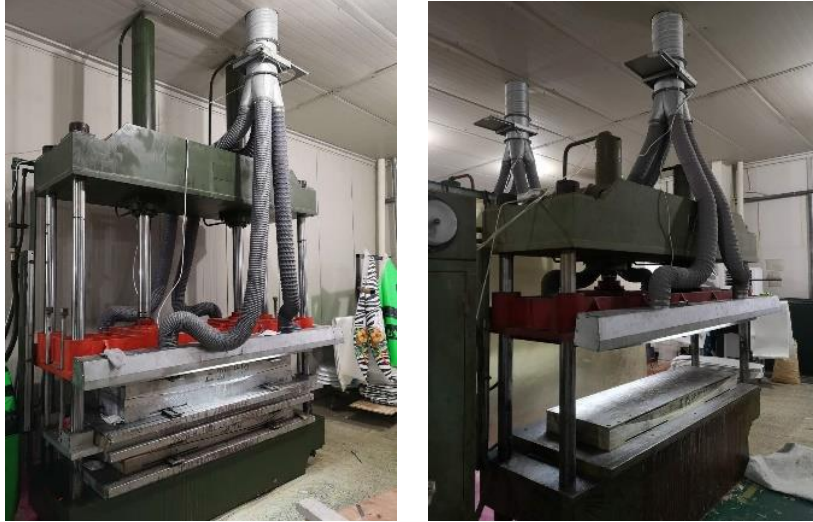
图 7-5 高档模压板车间及设备集气罩
