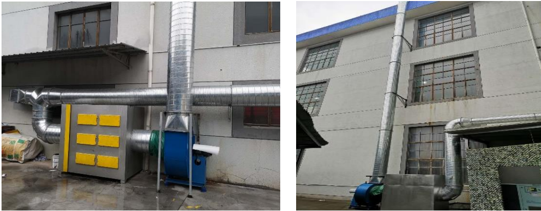
图 7-9 干式过滤+活性炭一体化设备
