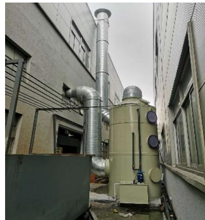
图 7-14 水喷淋吸收处理装置
