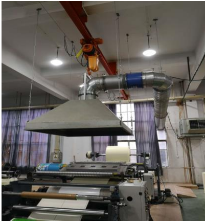
图 7-13 淋膜车间吸风罩及管道
