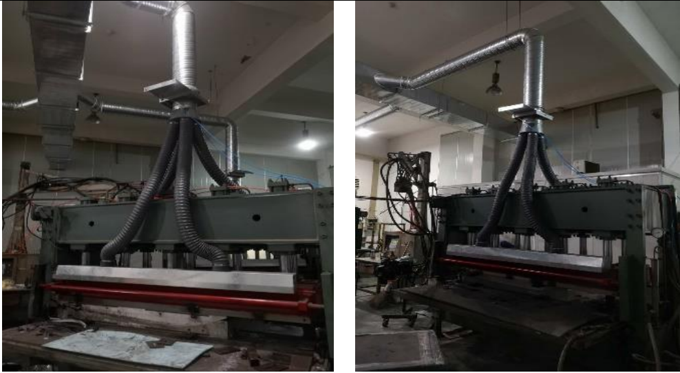
图 7-11 二号板压机吸风罩及管道
