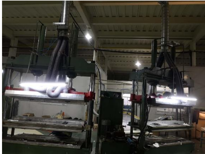
图 7-6 高档板发泡车间集气罩及收集管道
