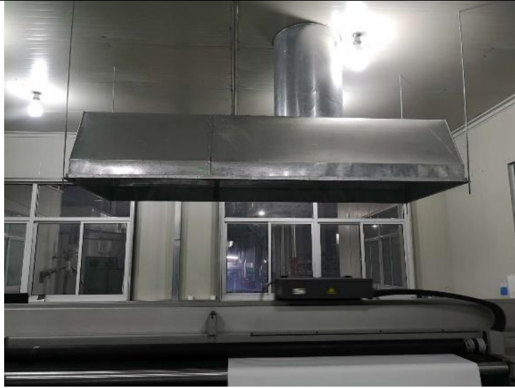
图 7-8 喷绘打印的吸风罩及管道
